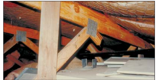
Do not cut truss webs. This condition needs a repair. No corte a los miembros secundarios de trusses. Esta condición necesita una reparación.
